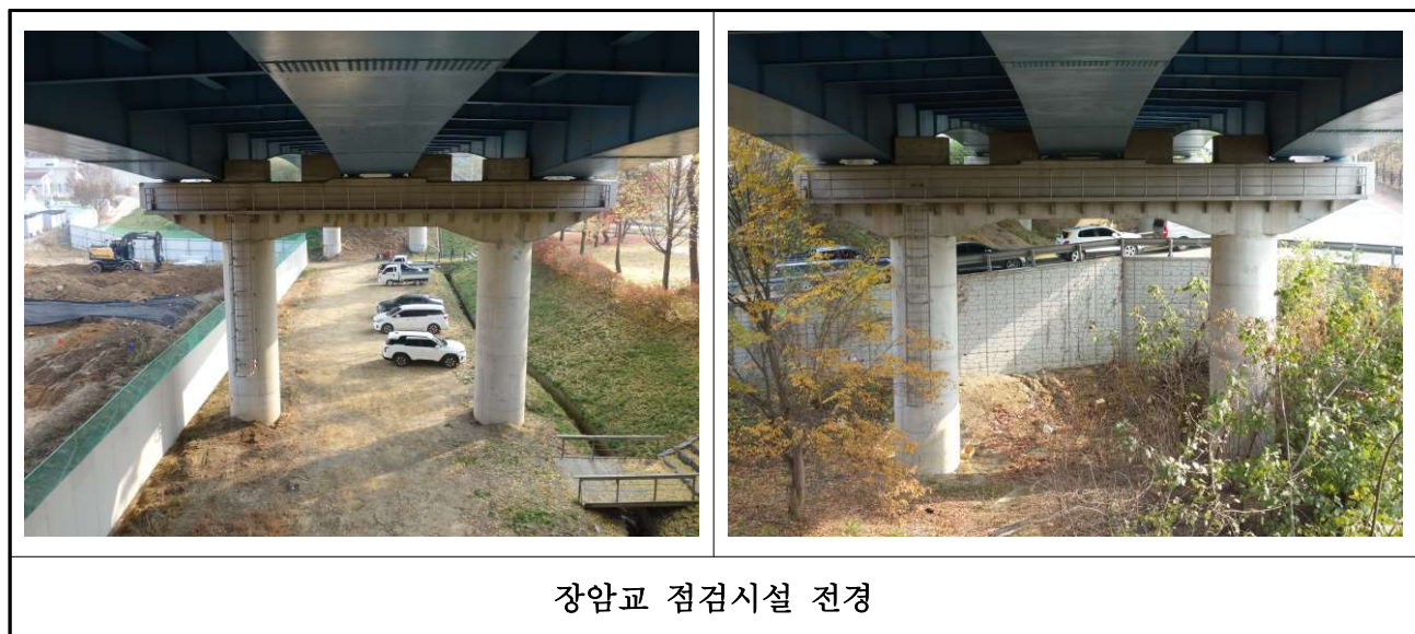
【그림 6.3】 점검시설 설치 현황
